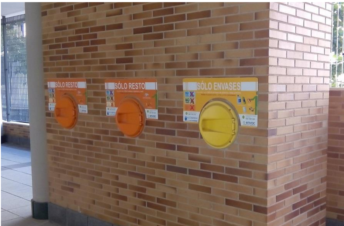
Figura 4 – Sistema de recogida neumática. Fuente: RP (2019, a)
